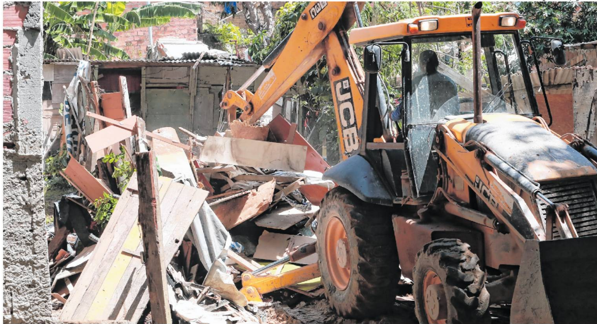
Os imóveis que foram demolidos pela Defesa Civil da capital ficavam no entorno do prédio de quatro andares que acabou caindo, causando a morte de quatro pessoas
