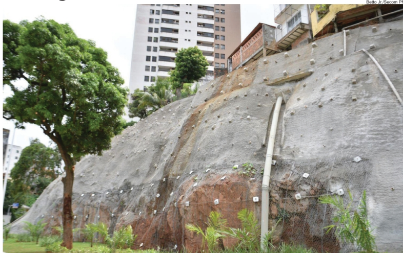
Contenção de encosta realizada pela Prefeitura na Praça dos Reis Católicos, no Vale do Canela
