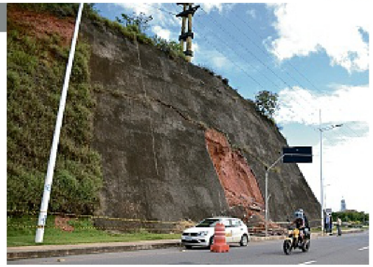
Interdição do trecho é preventiva, para evitar acidentes no local
