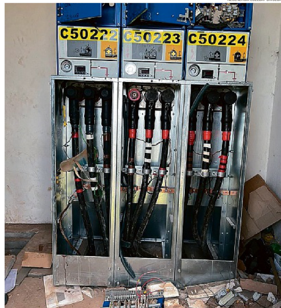
Segundo a Coelba, furto de cabos metálicos em equipamento na Paralela causou a queda de energia nos bairros
