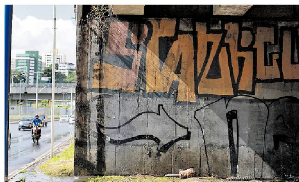
Inscrições estão presentes embaixo de viaduto situado na rótula do Abacaxi
