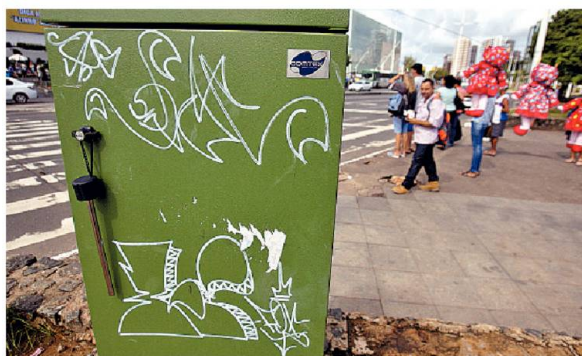
Desenhos foram riscados em caixa de energia instalada na região do Iguatemi
