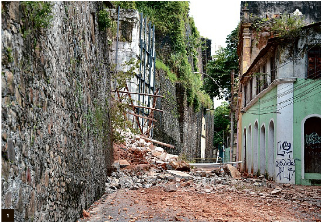
1 Ladeira da Montanha Paredo de casarão tombado pelo Iphan desabou e interditou via 2 Dois de Julho Árvore caiu na Rua da Faisca e foi escorada pelos fios de poste. 3 Subúrbio Deslizamento de terra causou bloqueio em parte da Estrada Velha de Periperi
