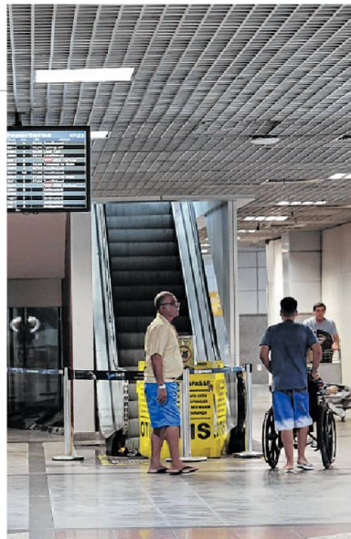
Escada rolante entre os dois pavimentos não funciona
