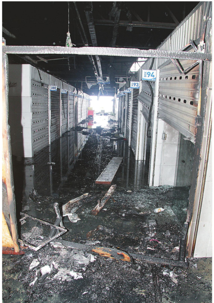
No andar superior, 20 boxes foram destruídos: permissionários passaram o dia contabilizando o prejuízo
