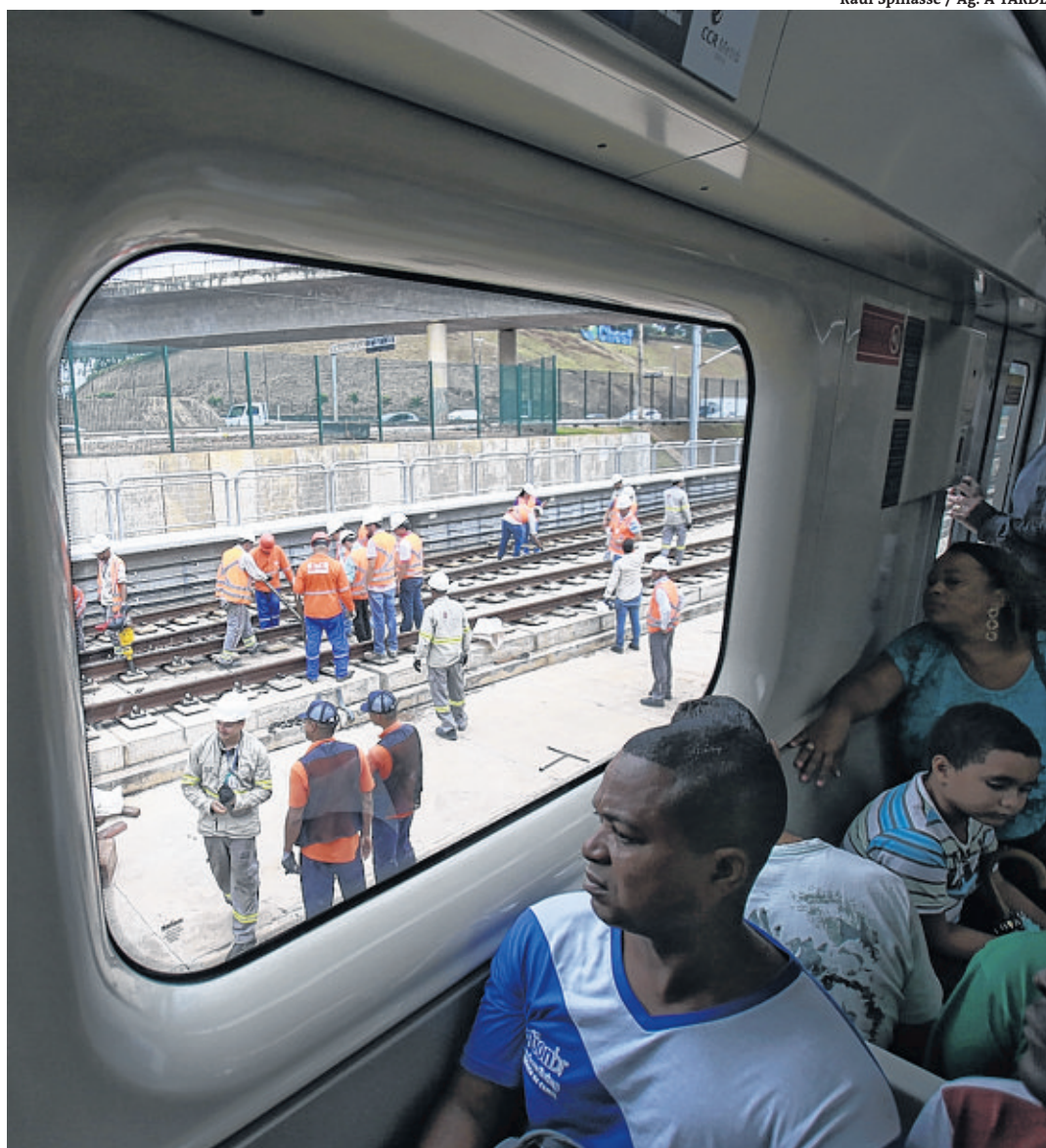
Equipe de técnicos da CCR trabalha em trecho da linha próximo ao estádio de Pituvaçu
