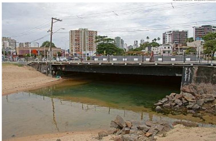
Bombas de peneiramento de resíduos, no Lucaia, não funcionam desde janeiro de 2016, aponta agência
