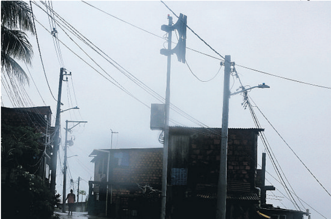
Uma das sirenes da Codesal acionadas ontem está instalada no Alto da Terezinha
