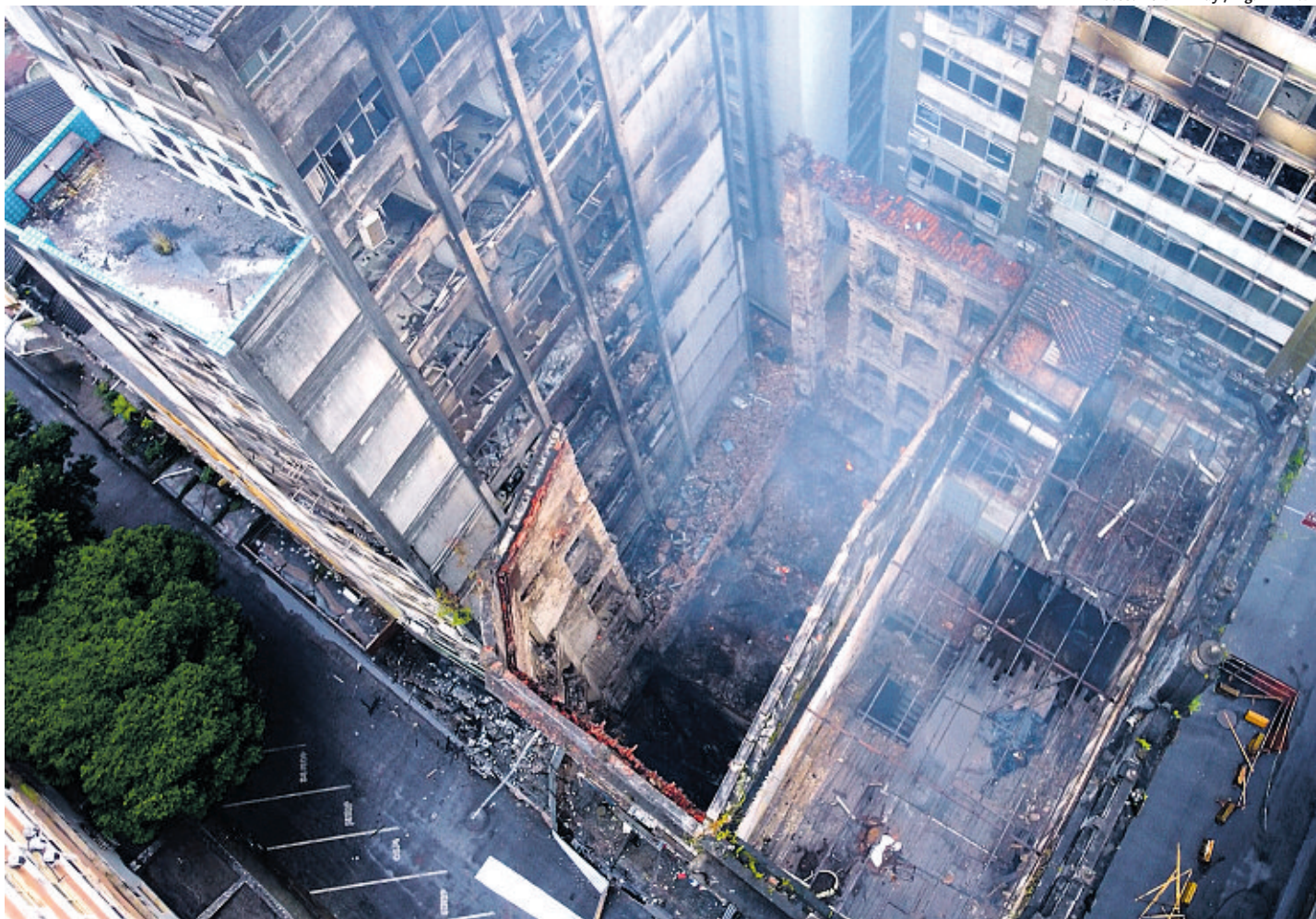
Relatório da Defesa Civil de Salvador aponta que mais de 2,7 mil imóveis estão em situação de vulnerabilidade
