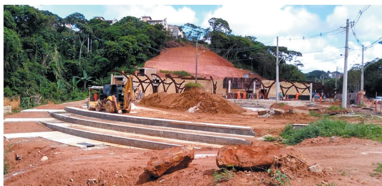
Urbanização do espaço ao redor da Pedra do Xangô prevê ainda o reflorestamento das áreas degradadas
