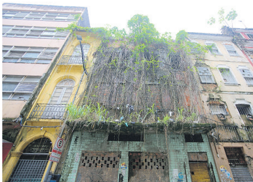
Bairro do Comércio possui diversos imóveis em estado precário
