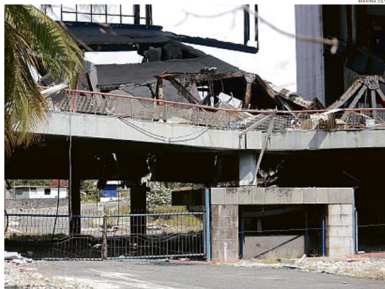
Desabamento parcial na parte da frente do equipamento ocorreu em setembro do ano passado, à noite
