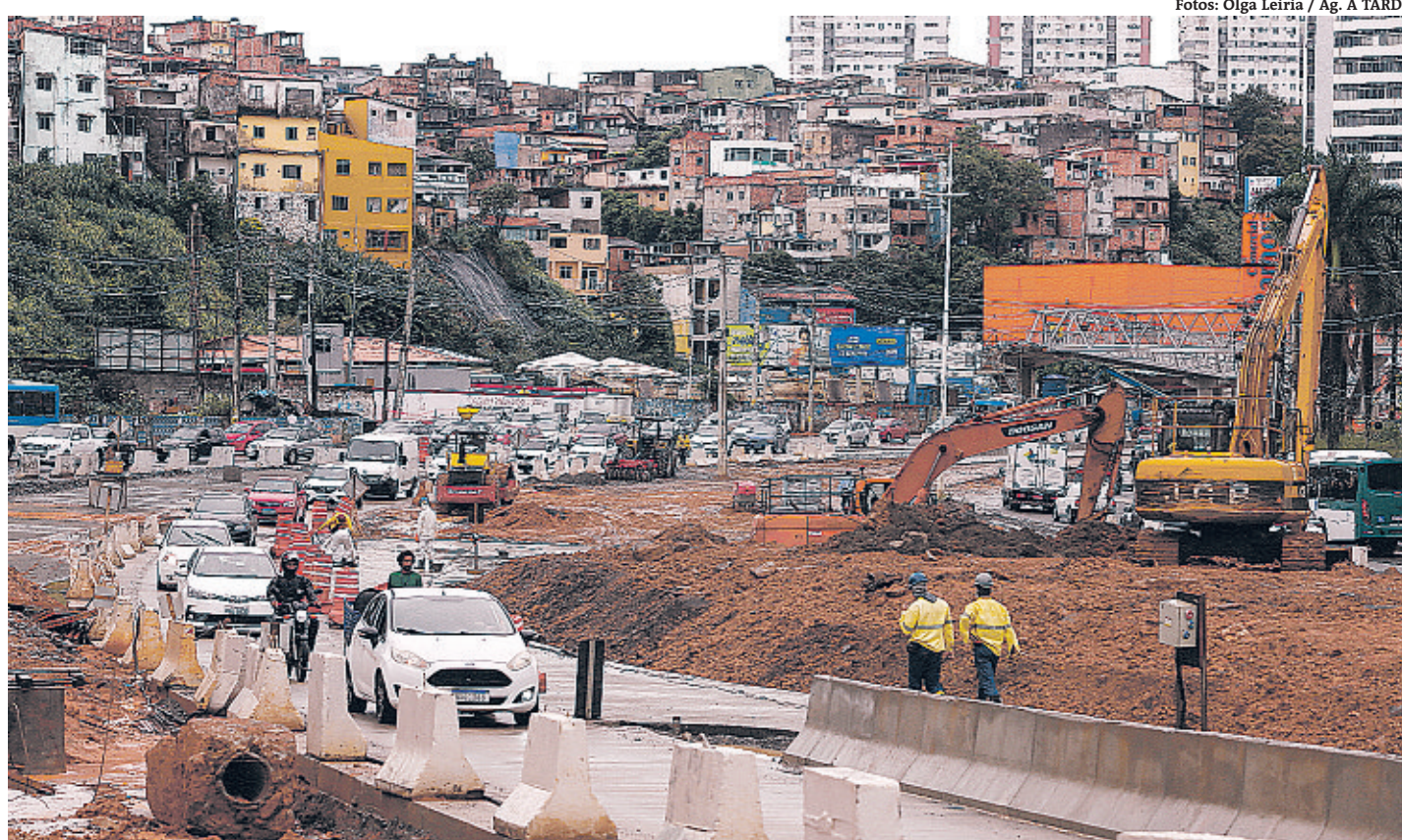
As alterações no trânsito costumam causar engarrafamentos em trechos das obras da Avenida ACM
