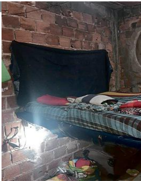
A casa tinha apenas um cômodo, com fogão de lenha, pouca ventilação, fiação exposta e sem reboco
