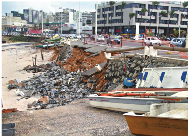
Parte da calçada cedeu na orla da Pituba, em frente à Praça Nossa Senhora da Luz, com a força das ondas
