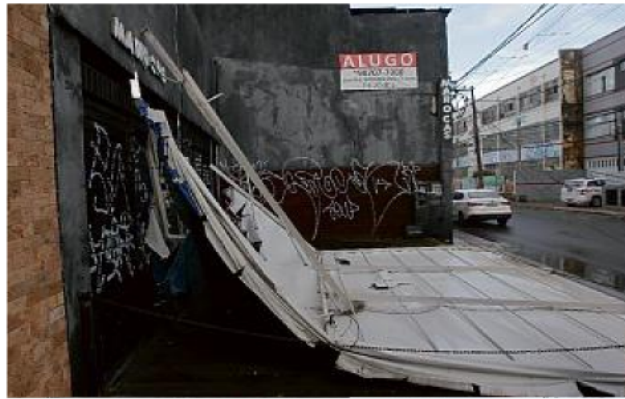
Vento forte derruba fachada de loja no Rio Vermelho; Codetal registrou 108 ocorrências até a noite de ontem, em toda Salvador
