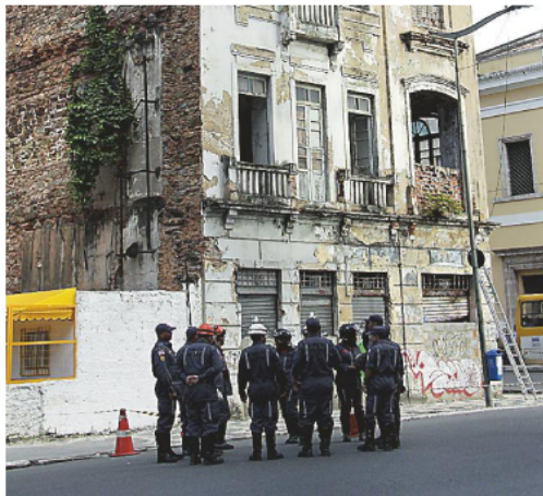
Parte de casarão secular desaba, na Rua da Bélgica, no Comércio, ALMIRO LOPES
