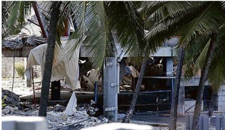
Desabamento de parte da estrutura do Centro de Convenções completa um ano neste mês de setembro
