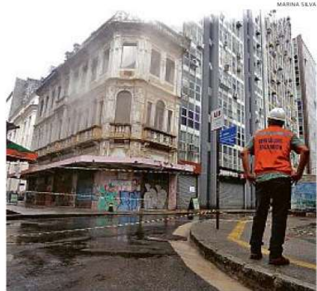
Casarão teve pequenos desabamentos na parte interna ontem
