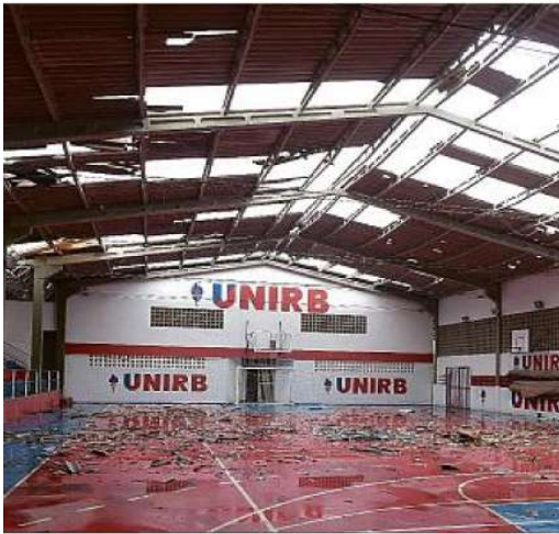
O vento destruiu a cobertura do ginásio de esportes da Unirb
