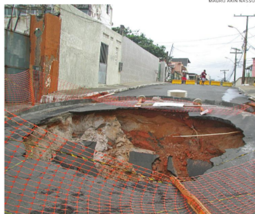
Cratera aberta em rua de Pituauçu ocupa os dois sentidos da pista
