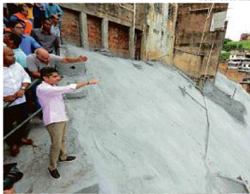
Geomanta foi instalada em um dos bairros onde mais chove na cidade
