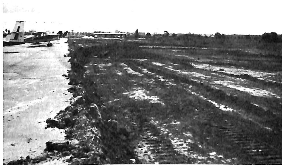
Acima, o pátio de estacionamento atual e, na outra foto, fase dos trabalhos preparatórios do subleito
