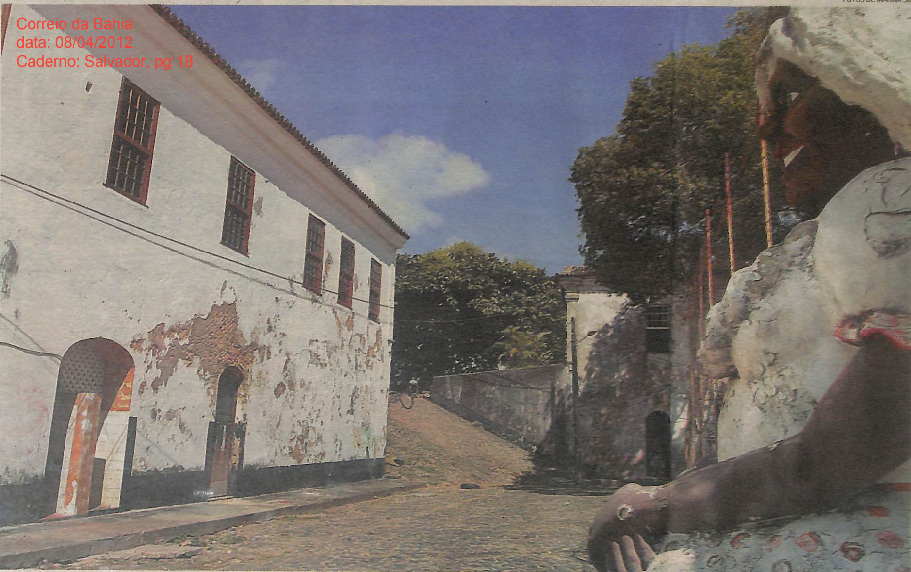
Tombado desde 1957 pelo Iphan, o Forte de Nossa Senhora do Monte do Carmo, conhecido como Forte do Barbalho, apresenta visíveis sinais de abandono
