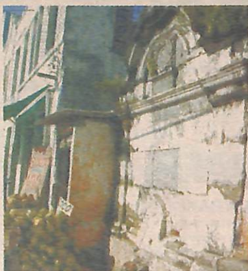
2 FONTE DA MUNGANGA Av. Jequitaia. Construída em 1704 e reformada em 1800. Funcionou até 1952. Tombada pelo Estado (1981). Hoje: está seca e sua estrutura deteriorada.
