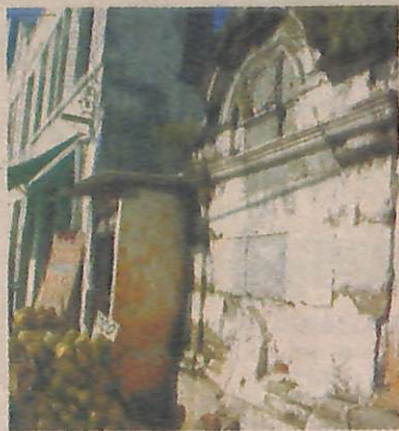
2 FONTE DA MUNGANGA Av. Jequitiaia. Construída em 1704 e reformada em 1800. Funcionou até 1952. Tombada pelo Estado (1981). Hoje: está seca e sua estrutura deteriorada.
