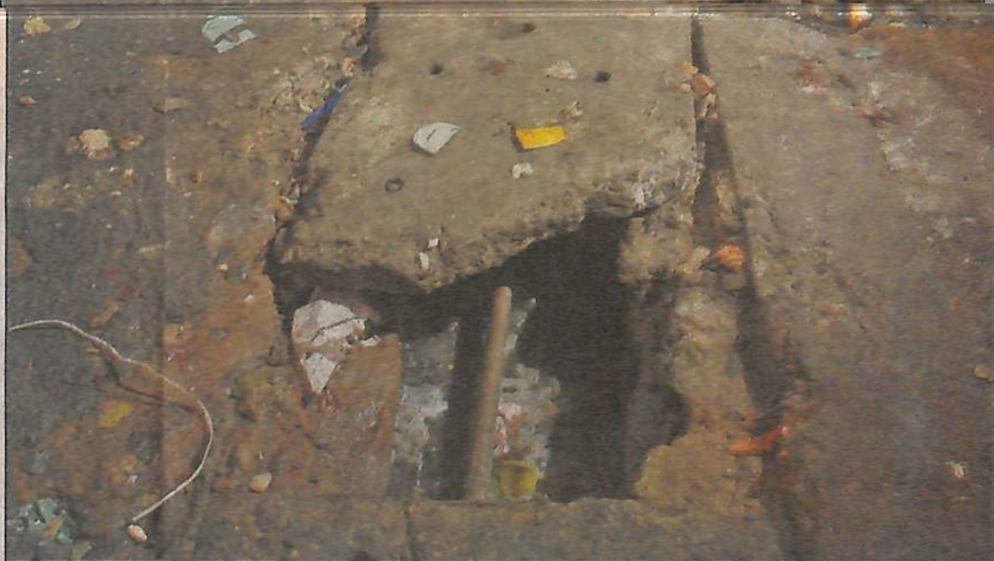
A estrutura no interior da Feira de São Joaquim apresenta-se danificada pelo tráfego de veículos
