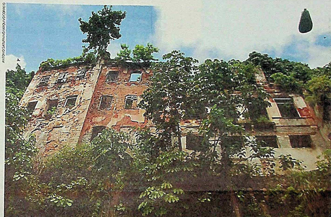
Casarão condenado na Ladeira da Montanha deverá ter placa apontando o grau de risco de desabamento, conforme decisão da Justiça
