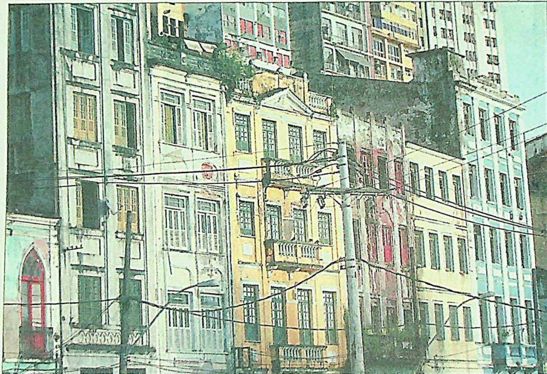
Pela fachada, dá para se dimensionar o precário estado de conservação dos casarões próximos ao Mercado Modelo
