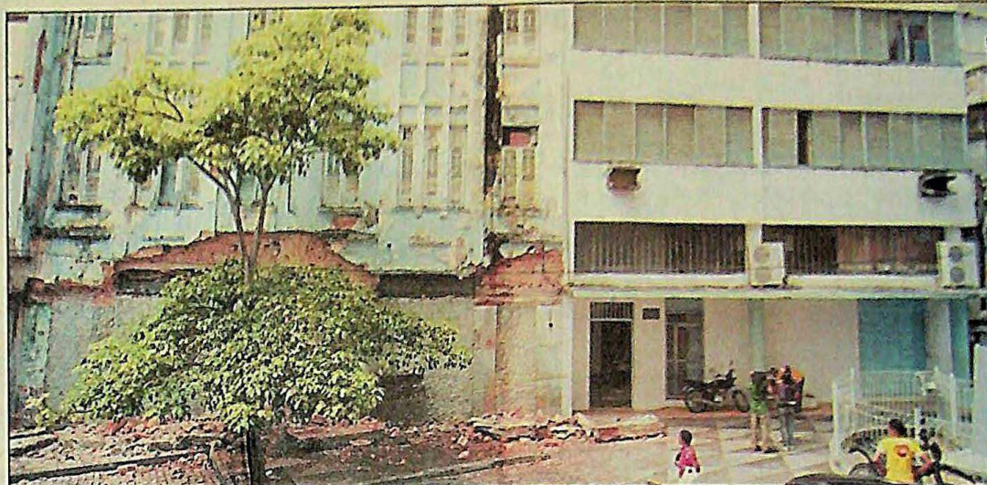
O imóvel de onde desabou a marquise fica ao lado do prédio secundário da Secretaria Municipal da Fazenda (Sefaz); risco para os transeuntes
