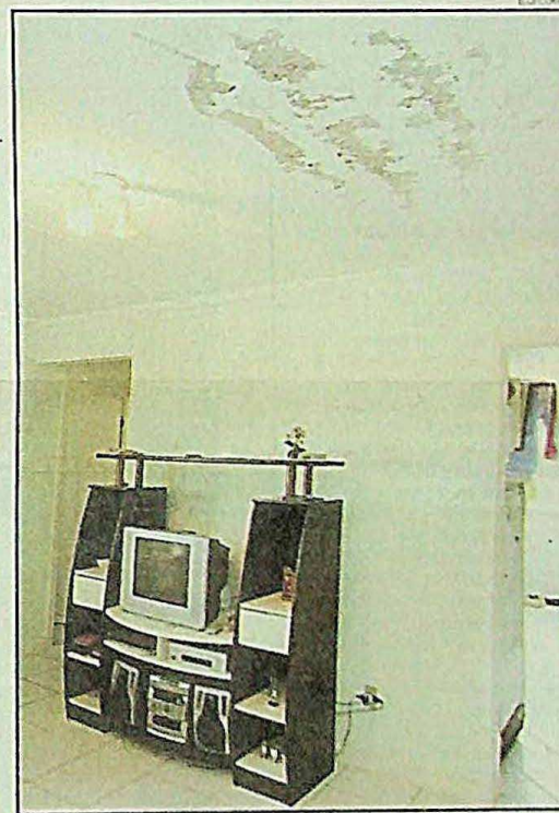
A infiltração produz danos nos prédios do Alto da Cachoeirinha
