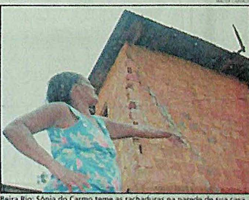
Beira Rio: Sônia do Carmo teme as rachaduras na parede de sua casa
