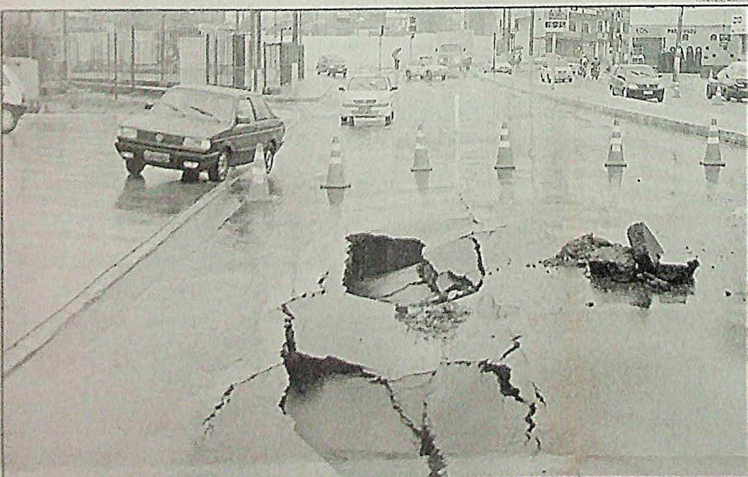
Parte da pista da Av. San Martin afunda devido às chuvas, resultando numa cratera; SET modifica o tráfego até à realização de reparos pela Sucom
