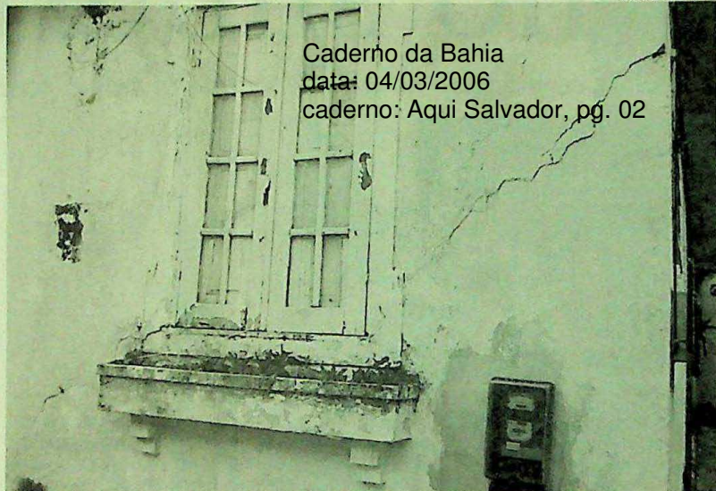
Habitantes da área estão apreensivos por causa das rachaduras já existentes em algumas casas
