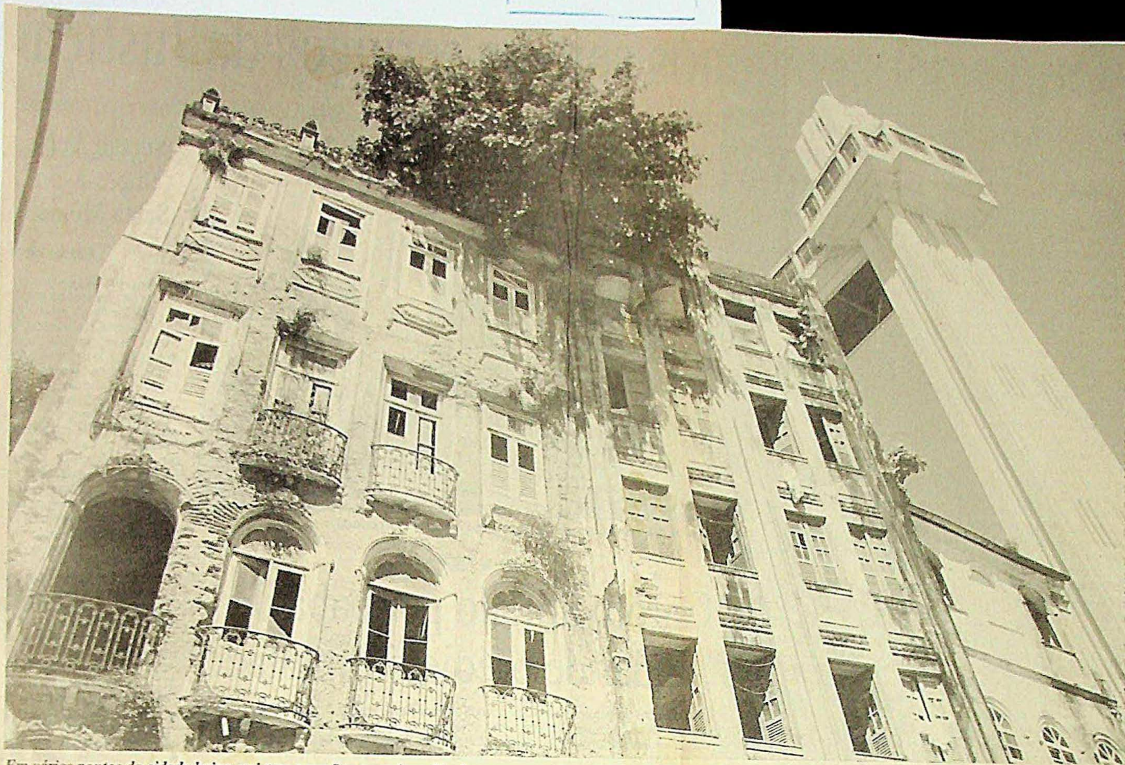
Em vários pontos da cidade baixa, existem casarões em ruínas. Um levantamento da prefeitura indica que 70 imóveis estão nestas condições em Salvador
