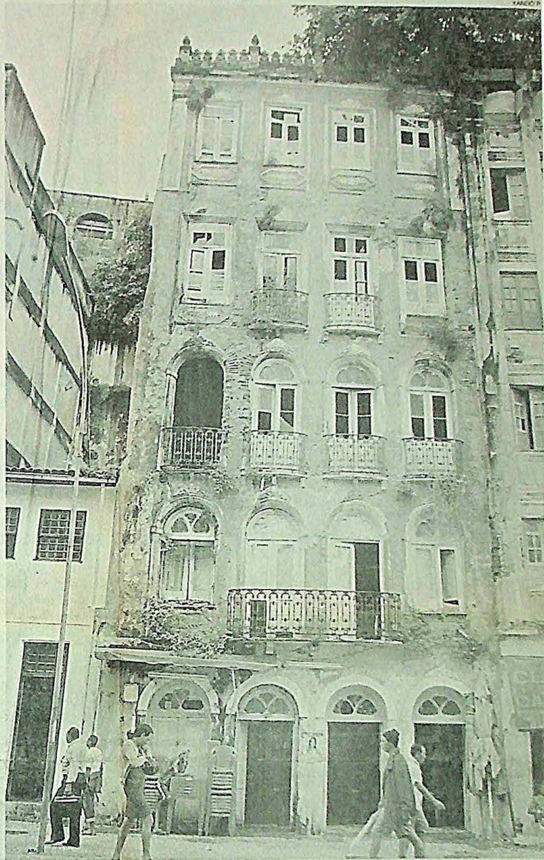
Sobrado na Cidade Baixa representa perigo para transeuntes e edificações vizinhas
