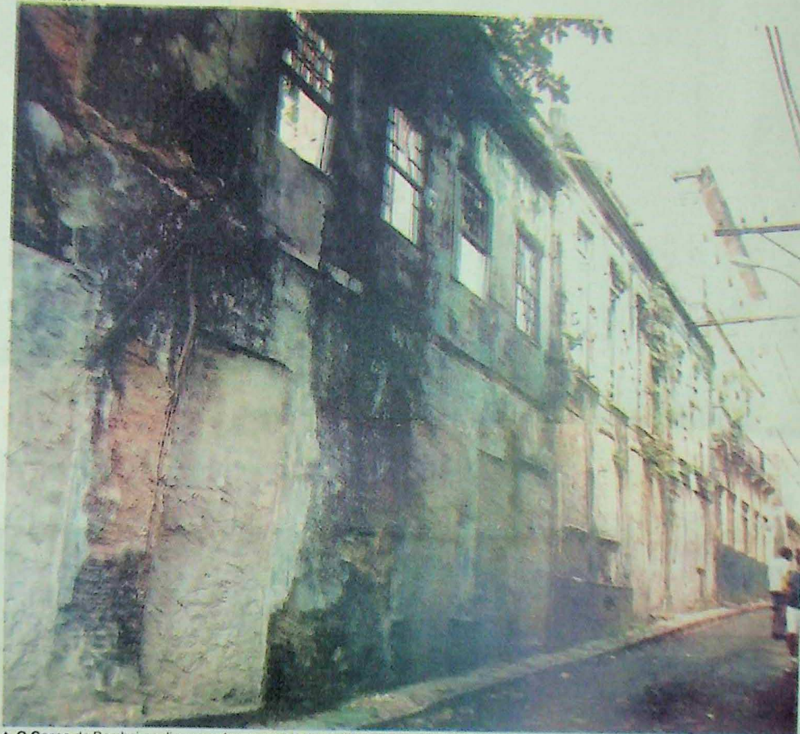
▲ O Corpo de Bombeiros diz que pelo menos 1/4 das edificações do Centro Histórico apresentam alto potencial de risco de incêndio
