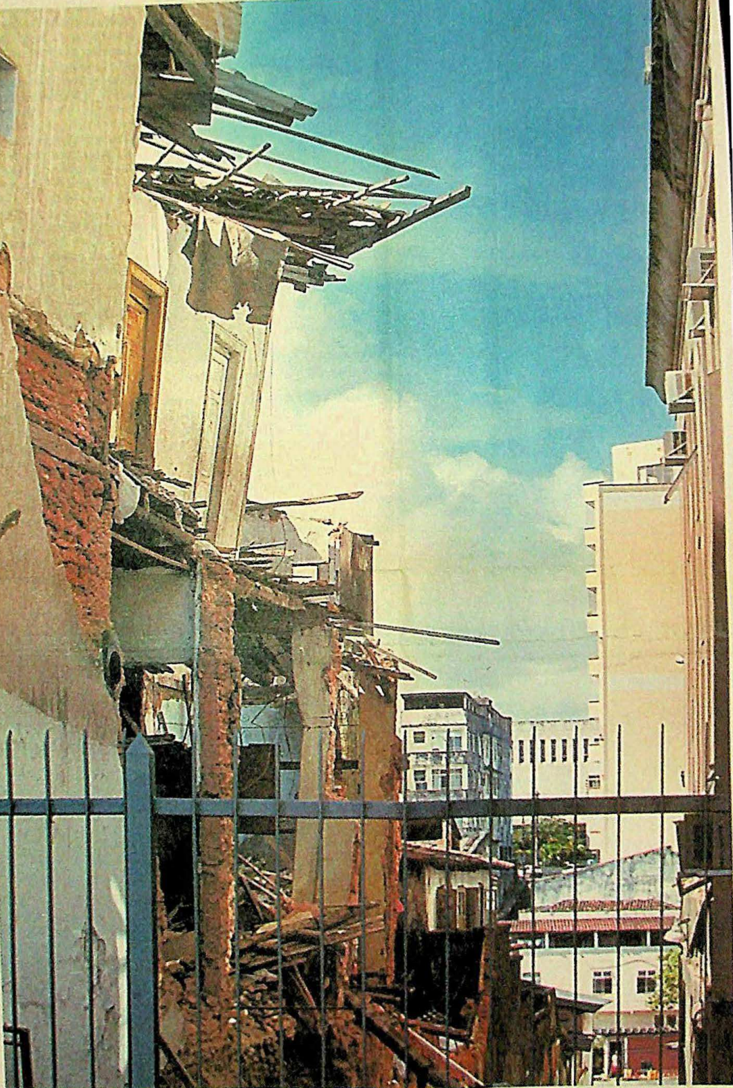
O imóvel da Rua Direita da Piedade estava condenado pela Defesa Civil desde 1999
