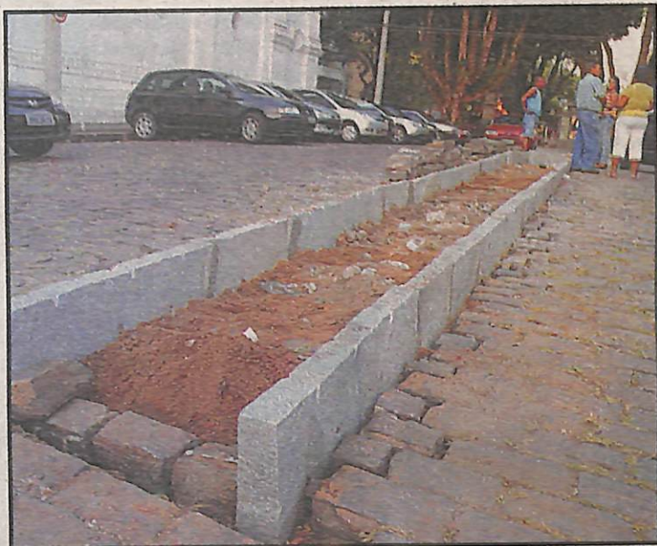
Autorizada pela prefeitura, construção “passa por cima” de lei federal
