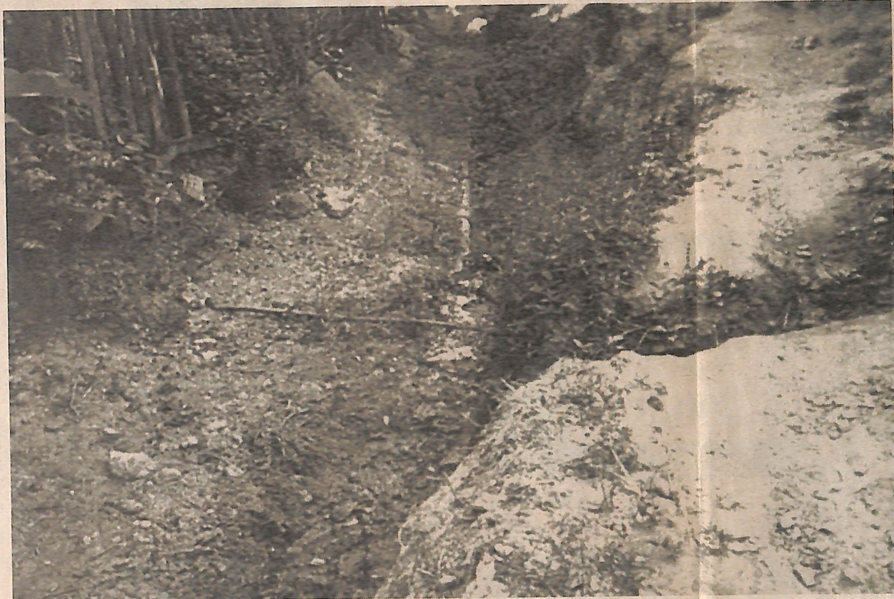
O tubo da rede de abastecimento de água da Embasa passa por dentro dos esgotos, em Plataforma
