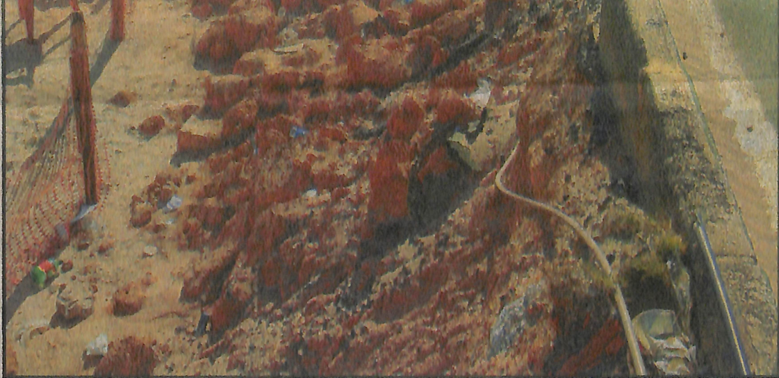
Parte da ciclovía, o calçamento e a escadaria cederam em virtude da ressaca do mar no mês de setembro
