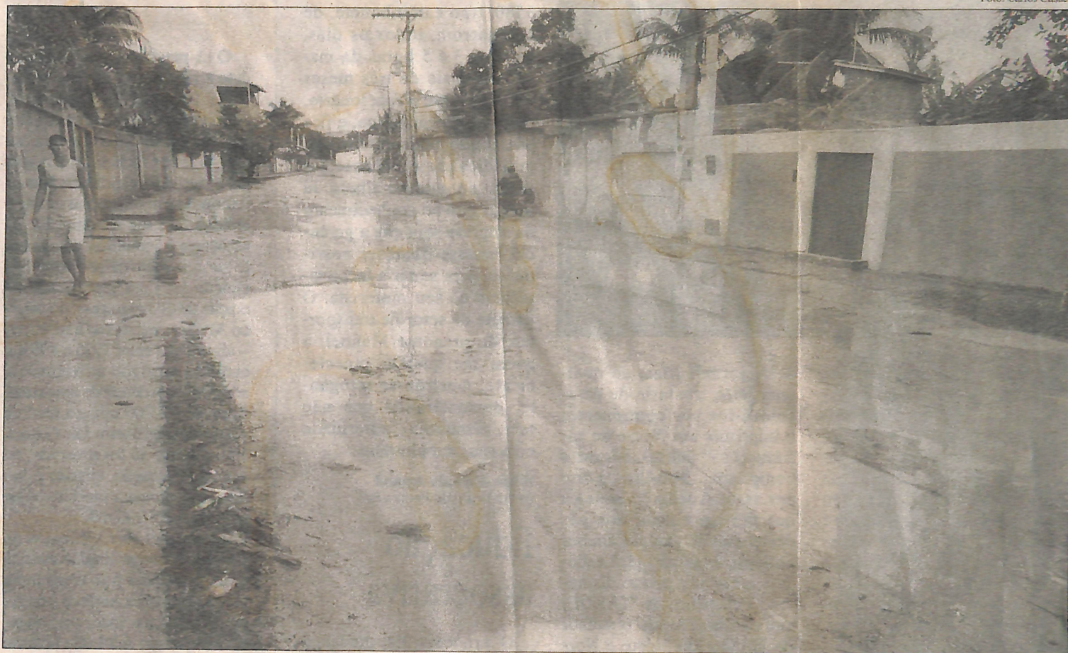
A Rua Juiz Heleno de Melo vira um lamaçal nos dias de chuva, prejudicando o trânsito de veículos e pessoas
