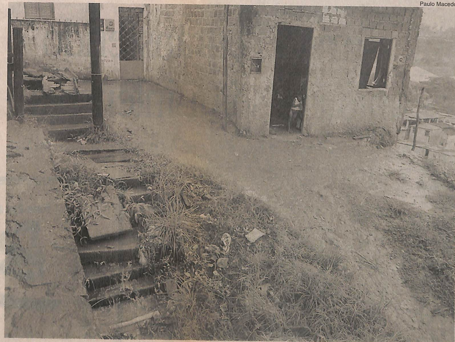
As escadas drenantes danificadas expõem moradores ao contato com a água do esgoto que corre a céu aberto
