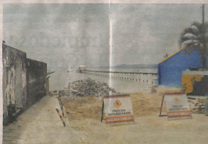
Trecho da Rua Artur Matos, onde começa a nova pista, já interditado
