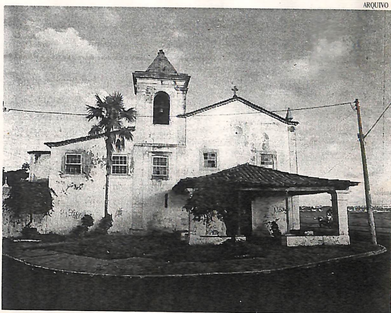
A igreja de Monte Serrat apresenta problemas em sua estrutura
