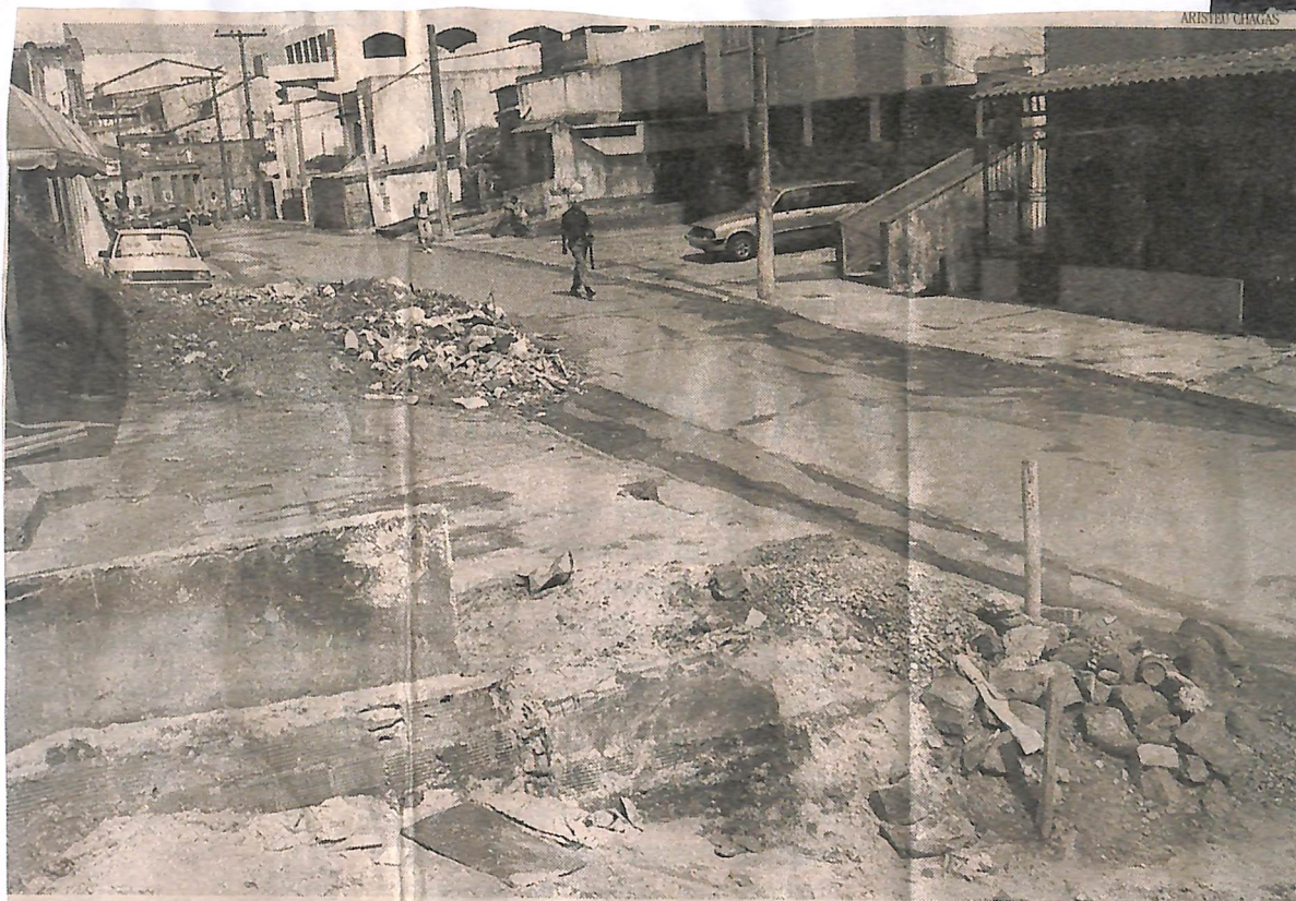
Buraco com mais de um metro de profundidade que foi deixado pela Embasa expõe moradores ao perigo
