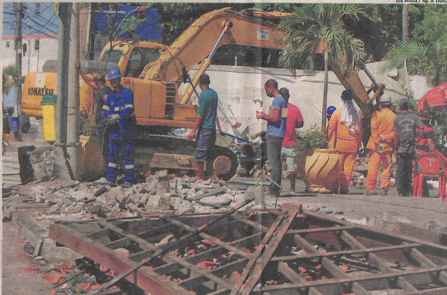
A barraca de Cira, famoso point de acarajé instalado no bairro, foi um dos estabelecimentos derrubados ontem
