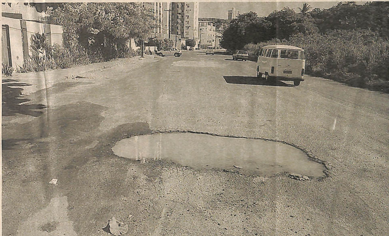
Nas imediações do Colégio Ímpar, buraco fica cada vez maior e quebra-molas foram destruídos por obra
