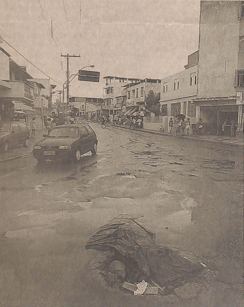
Buracos na pavimentação também fazem parte do cotidiano do bariro
